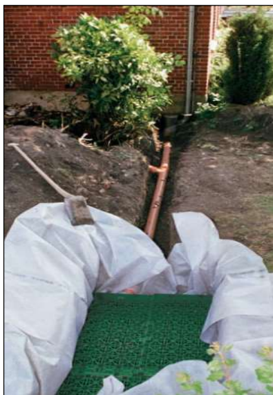
Figur 19 Dagvattenkassetter för fördröjning av takdagvatten
