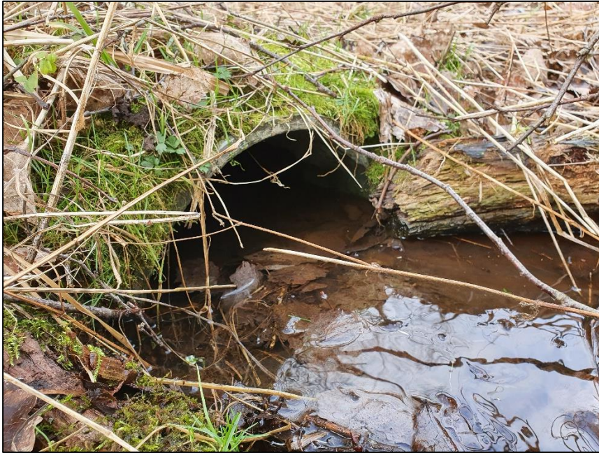
Figur 7. 300 mm trumma utmed diket (Foto: Norconsult).
