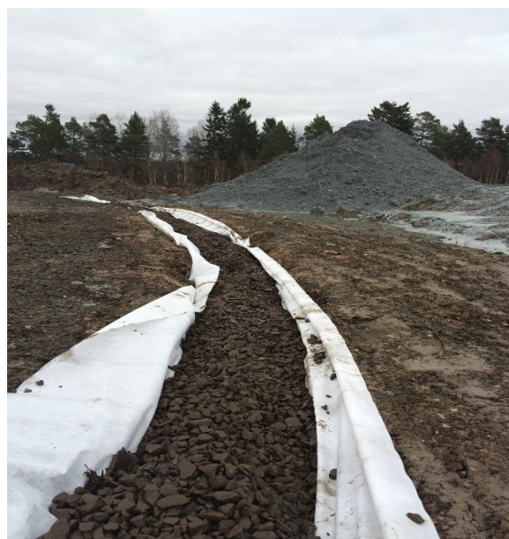
Dränerande material i gasdränering vid Borreboda i Töreboda
