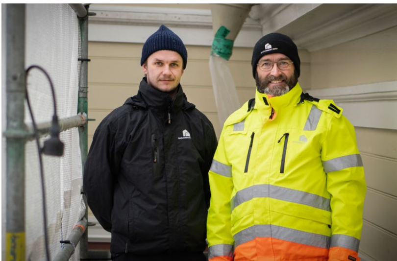
Nils Liljebo och Mattias Eriksson inspekterar fasadrenoveringen av den gamla flickskolan på Skolgatan.
