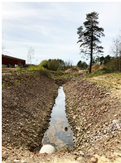
Befintligt dagvattendike i nordost.
