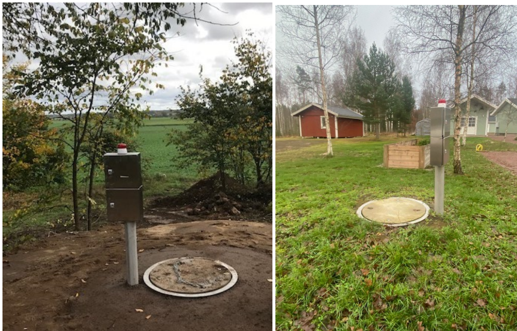
Bild på synliga delar av LTA-enheten efter installation
