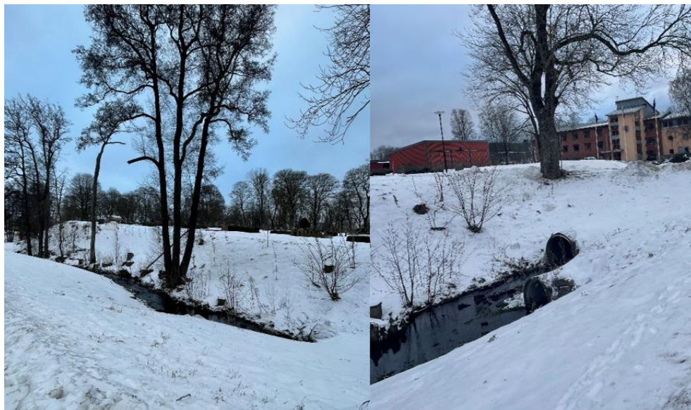
Figur 12. Garpabäcken kommer i dagen genom en trumma och flera tillflöden ansluts genom trummor och ledningar, bland annat från planområdet. Bilder från platsbesök 2026-01-22 utfört av Tyréns.
