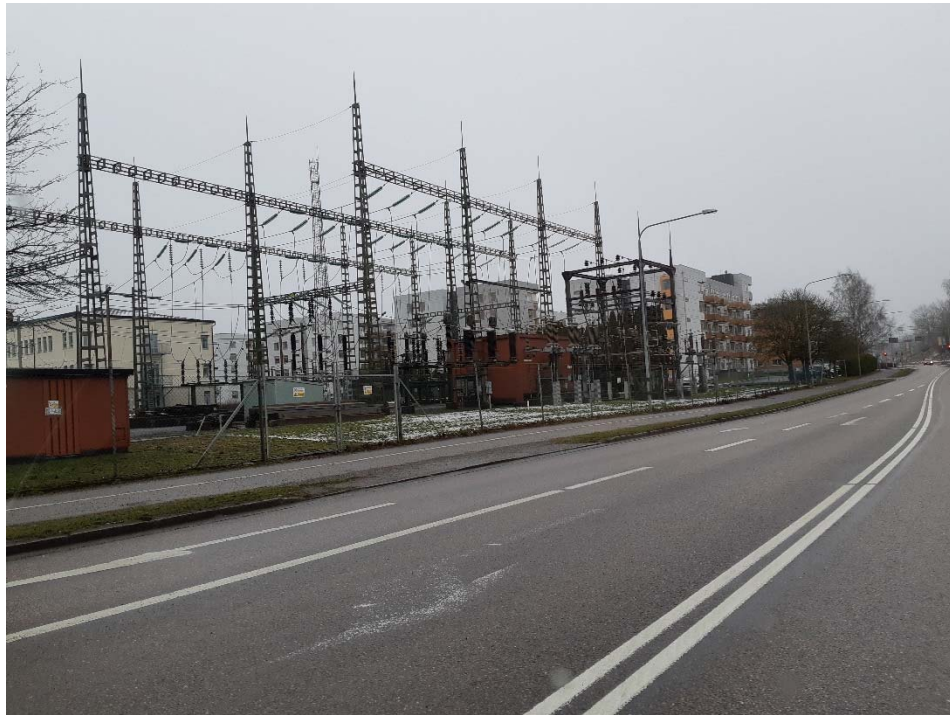
Figur 12. Motorn 1, vy mot söder.
