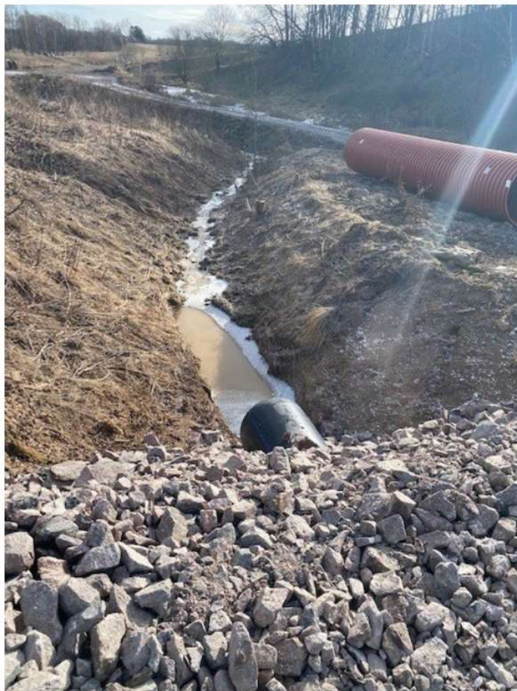
Figur 13. Tillfälligt dagvattensystem på Risatorp, 2023-03-06. Nedström av projektområdet.
